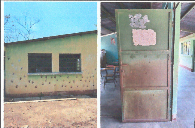
Foto 3: Necesidad de remozamiento en pintura del establecimiento
