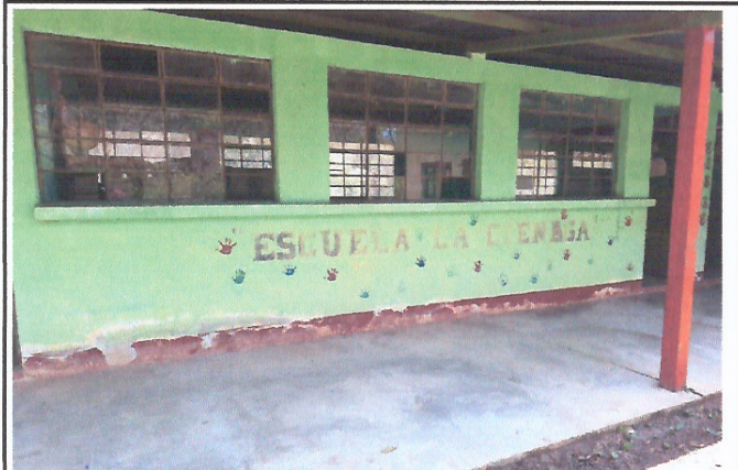
Foto 4: La pintura de todo es el establecimiento esta deteriorada
