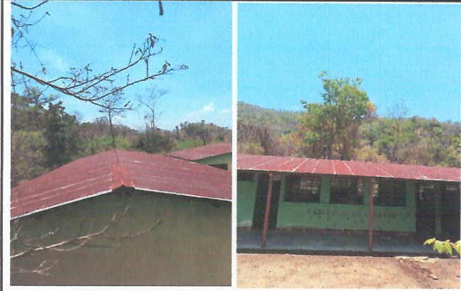
Foto 1: Se necesita cambio de techo del establecimiento por una lámina de mejor calidad
